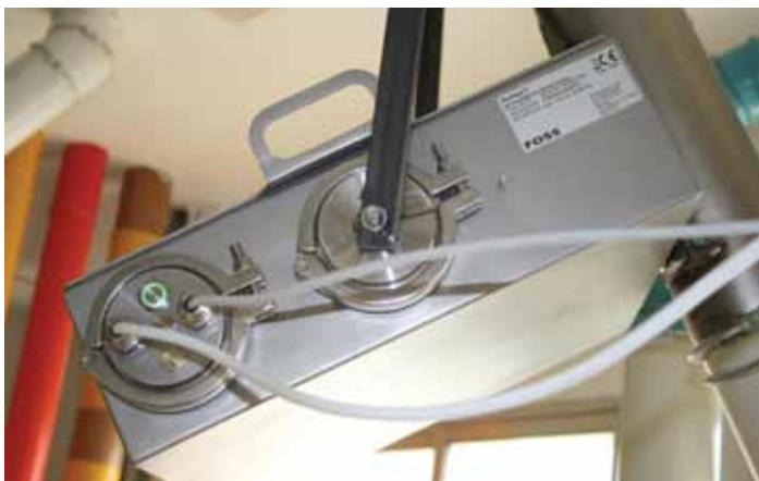
ProFoss misst das Mehl, während es mit einer Geschwindigkeit von bis zu 25 Metern pro Sekunde durch die Rohre geleitet wird.
